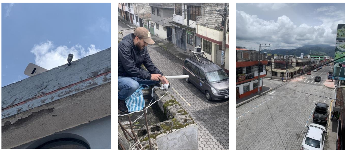
Fotografías: Instalación de cámaras de video para el conteo de vehículos
