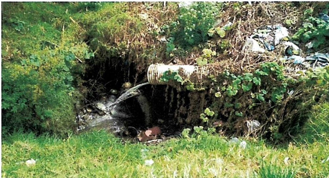
Figura 2. Cruce de quebrada.
