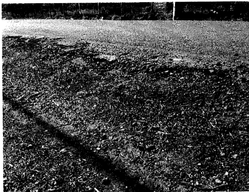
Fotografía Nro. 9. Descascaramiento de borde – Vía Aychapicho
