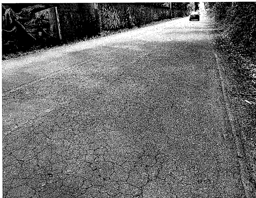
Fotografía Nro. 4. Piel de Cocodrilo – Vía Aychapicho.
