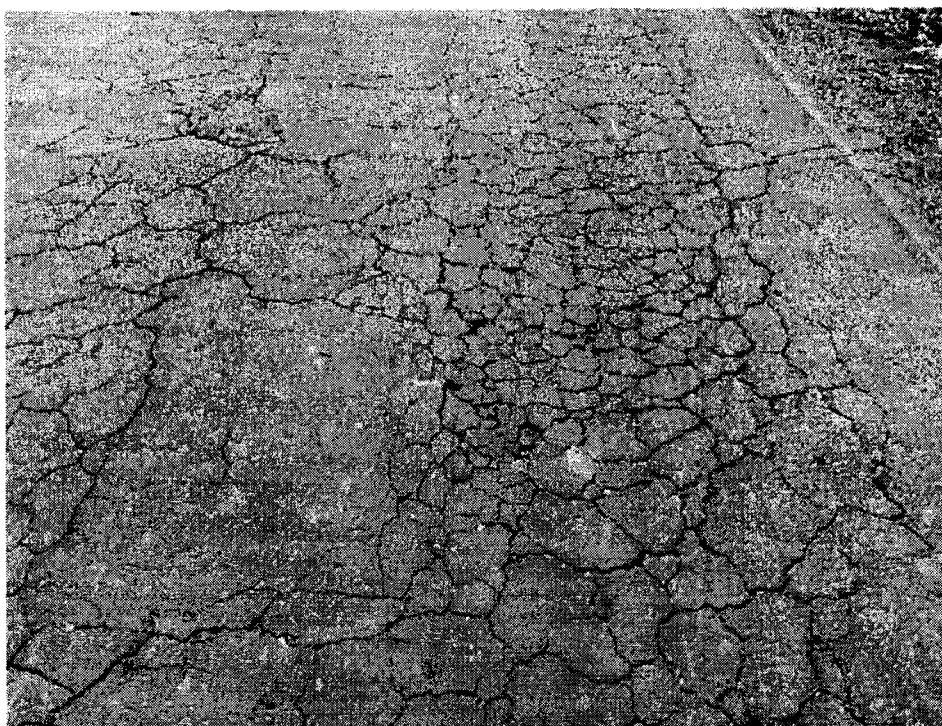
Fotografía Nro. 2. Piel de Cocodrilo – Vía Aychapicho
