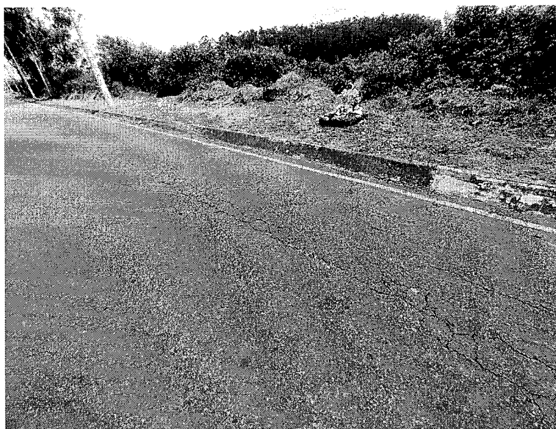
Fotografía Nro. 12. Fisura longitudinal – Vía Aychapicho
