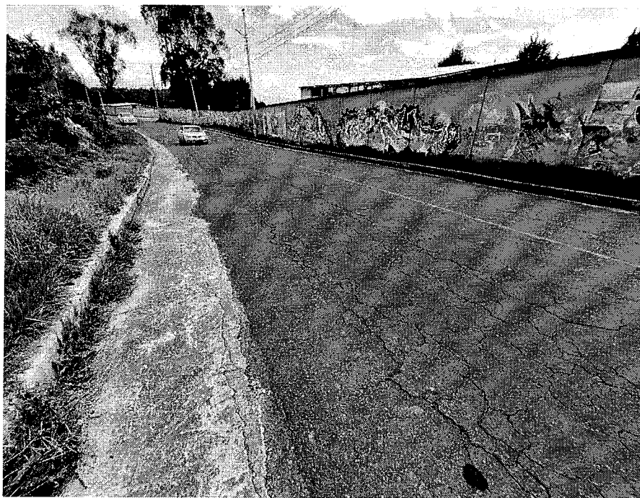
Fotografía Nro. 5. Ahuellamiento en la vía
