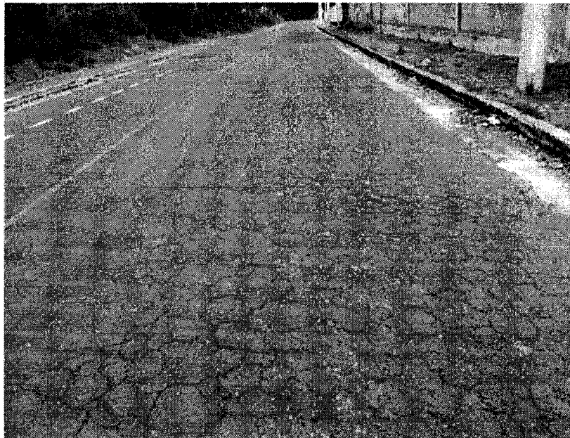
Fotografía Nro. 3. Piel de cocodrilo – vía Aychapicho
