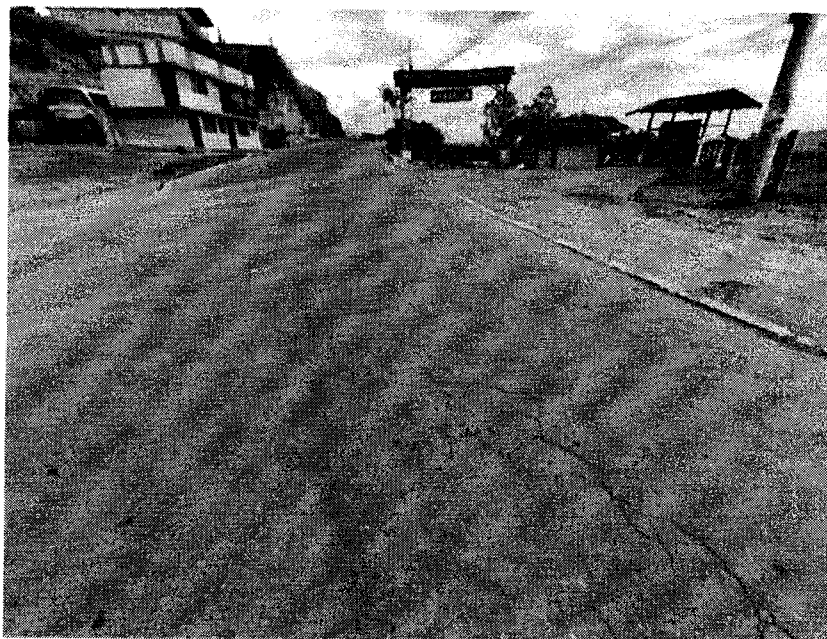
Fotografía Nro. 7. Fisuras en Bloque
