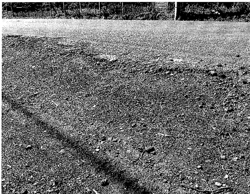
Fotografía Nro. 9. Descascamiento de borde – Vía Aychapicho
