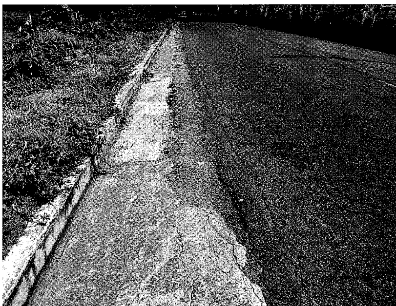
Fotografía Nro. 8. Fisuras y descascaramiento en el borde de Vía Aychapicho.
