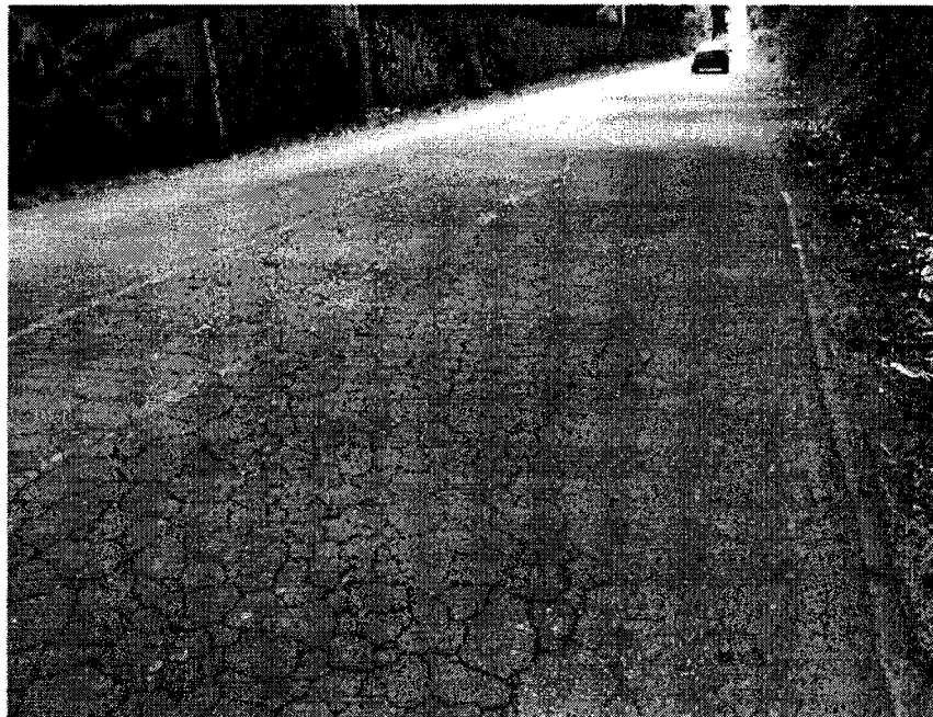
Fotografía Nro. 4. Piel de Cocodrilo – Vía Aychapicho.
