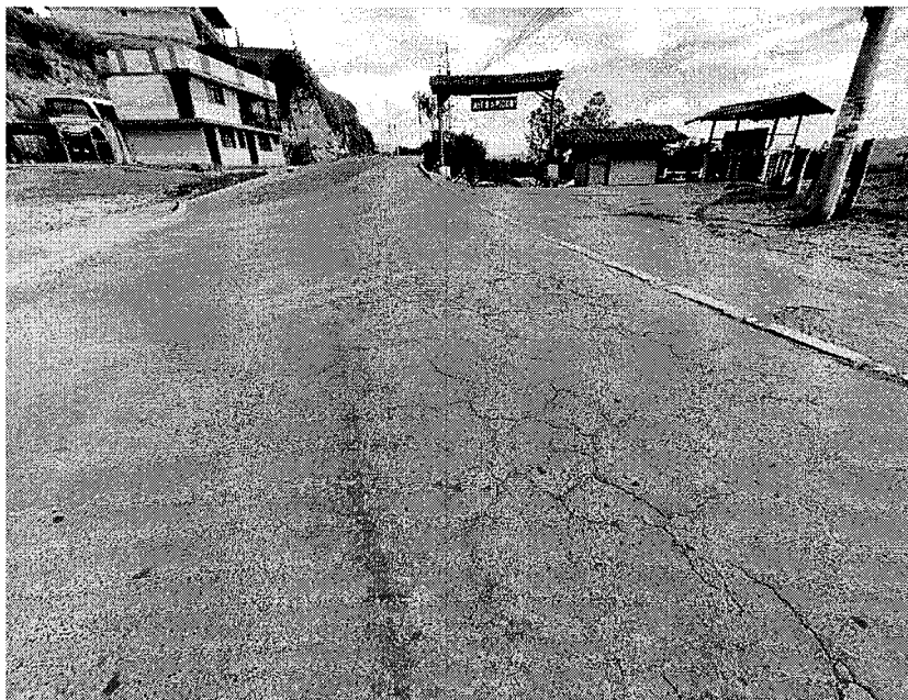
Fotografía Nro. 7. Fisuras en Bloque
