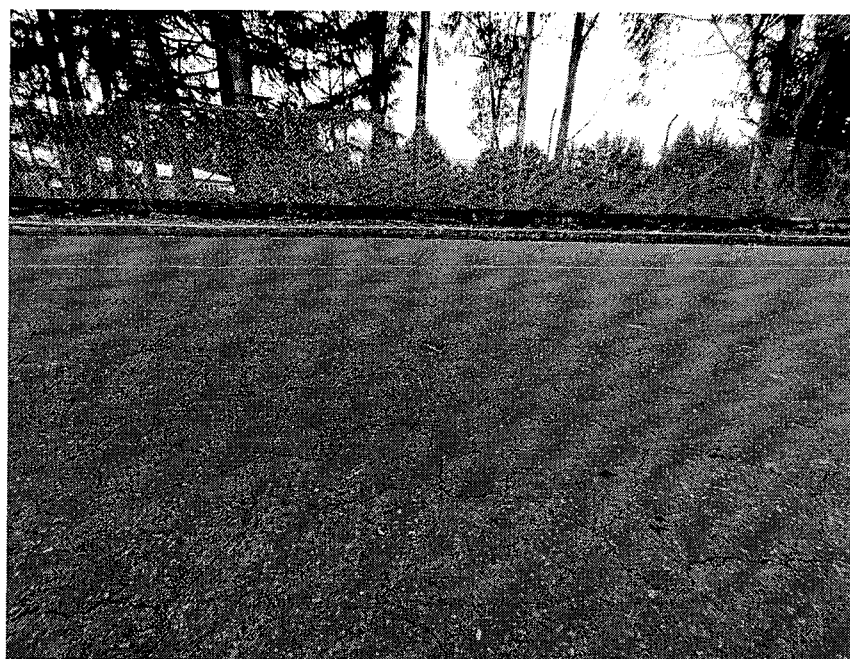
Fotografía Nro. 6. Fisuras en Bloque.
