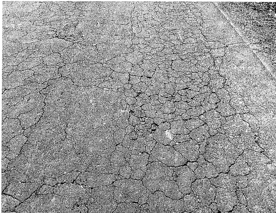
Fotografía Nro. 2. Piel de Cocodrilo – Vía Aychapicho
