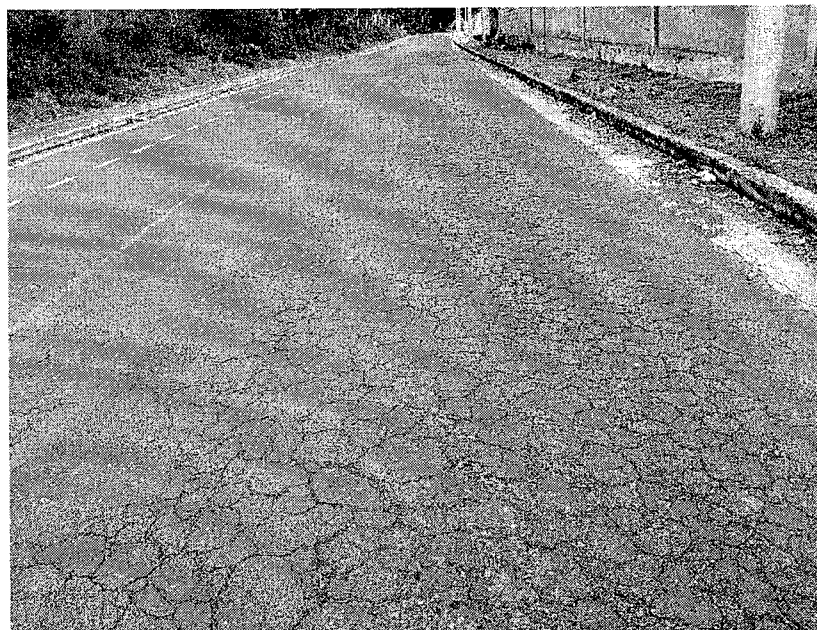
Fotografía Nro. 3. Piel de cocodrilo – vía Aychapicho
