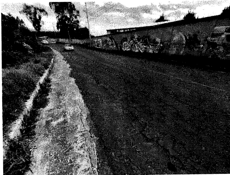
Fotografía Nro. 5. Ahuellamiento en la vía
