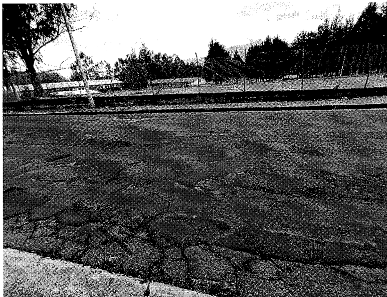
Fotografía Nro. 11. Parches, vía Aychapicho
