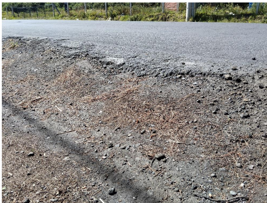
Fotografía Nro. 9. Descascaramiento de borde – Vía Aychapicho
