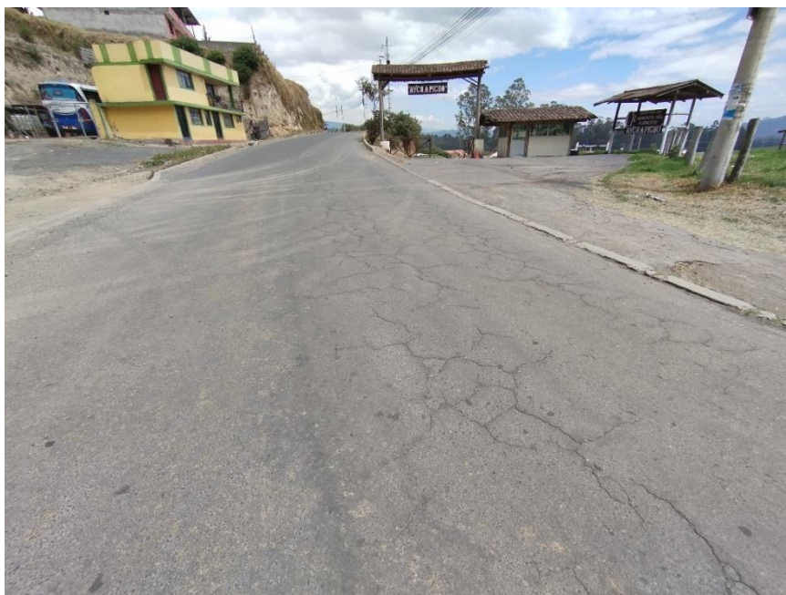
Fotografía Nro. 7. Fisuras en Bloque
