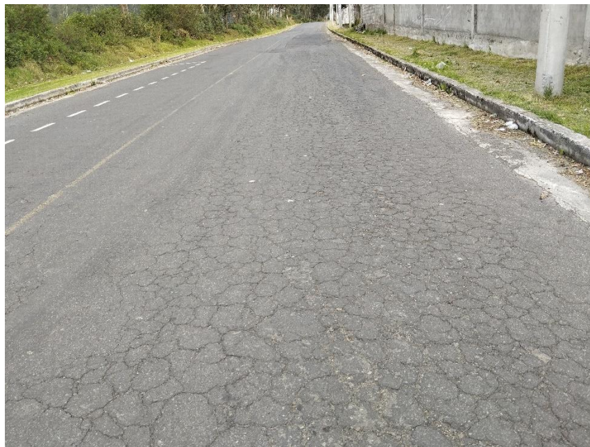
Fotografía Nro. 3. Piel de cocodrilo – vía Aychapicho
