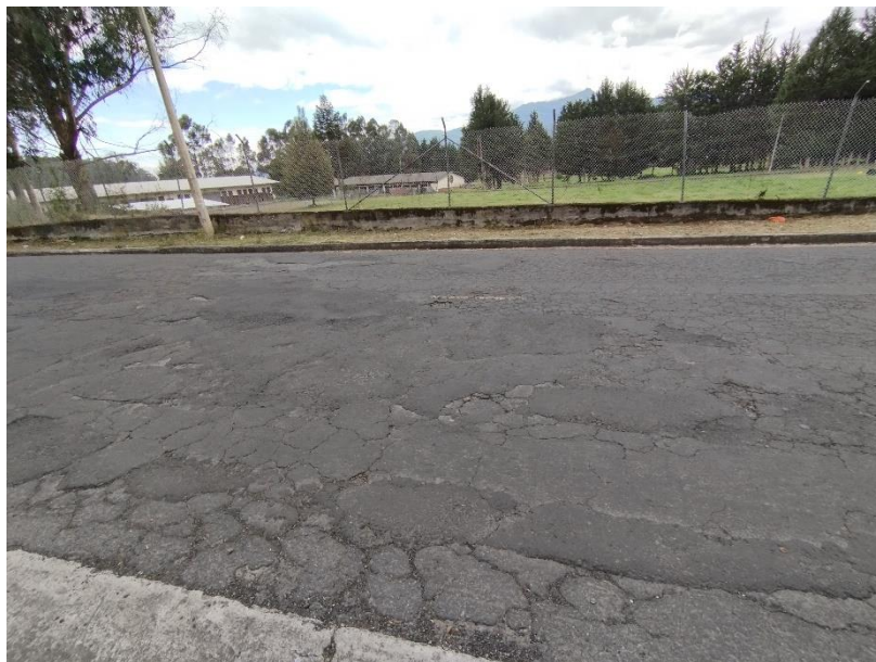
Fotografía Nro. 11. Parches, vía Aychapicho
