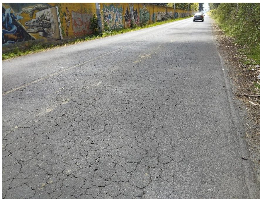
Fotografía Nro. 4. Piel de Cocodrilo – Vía Aychapicho.
