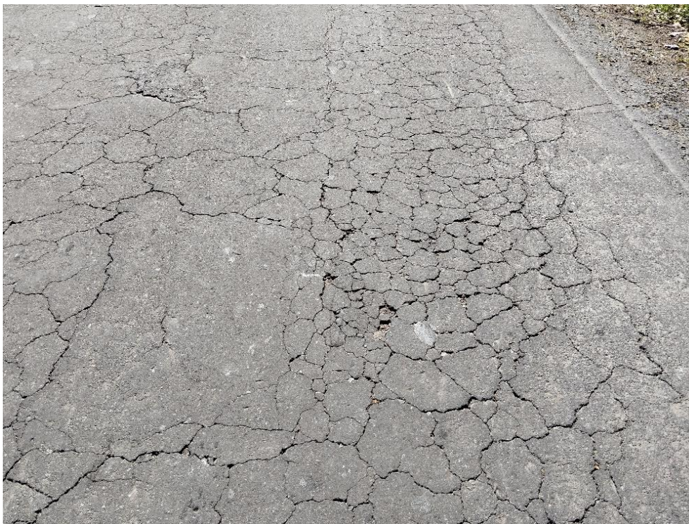
Fotografía Nro. 2. Piel de Cocodrilo – Vía Aychapicho
