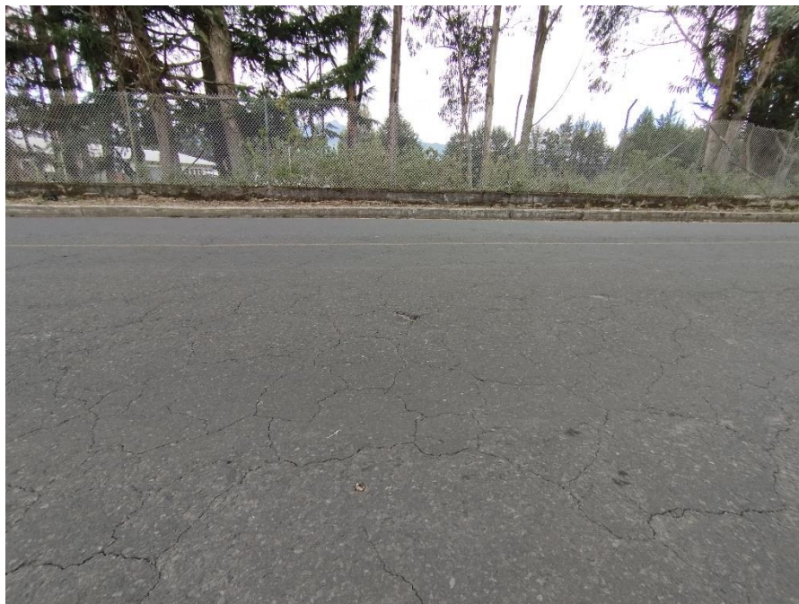
Fotografía Nro. 6. Fisuras en Bloque.
