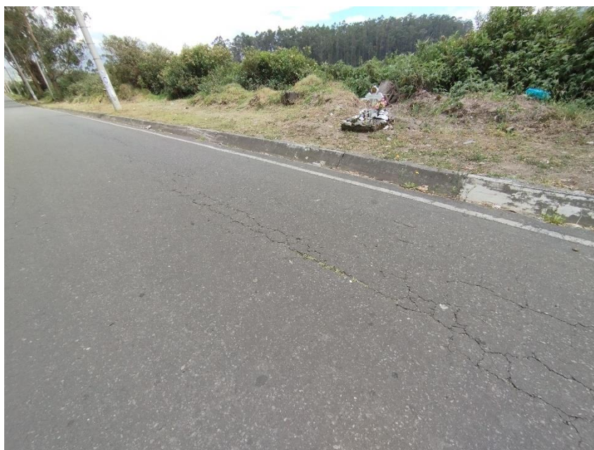
Fotografía Nro. 12. Fisura longitudinal – Vía Aychapicho
