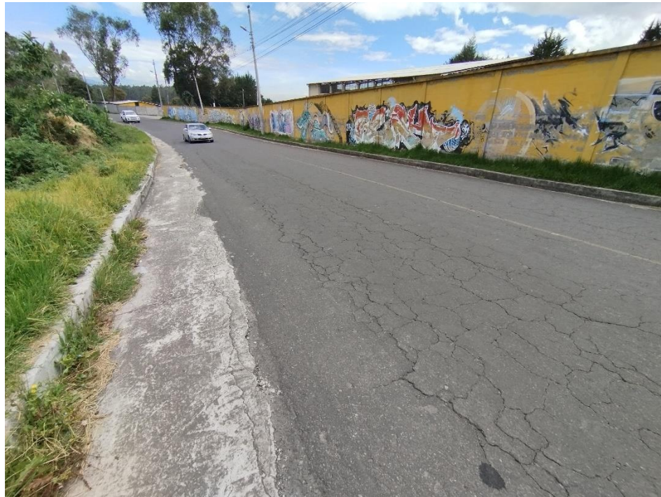
Fotografía Nro. 5. Ahuellamiento en la vía
