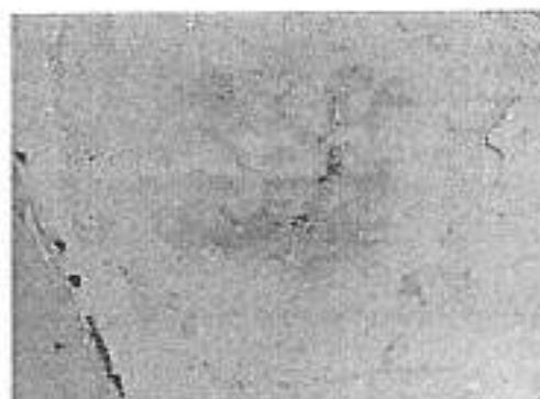
Fotografía N° 2 Humedades y trizaduras en tumbado
