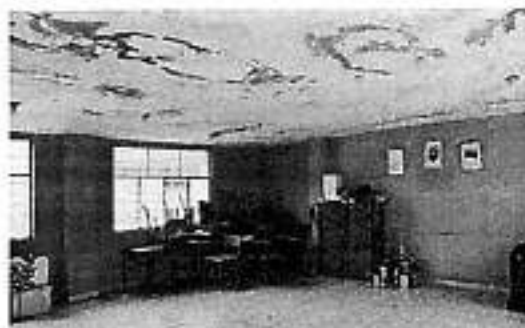
Fotografía N° 5 Humedades tumbado – salón desocupado
