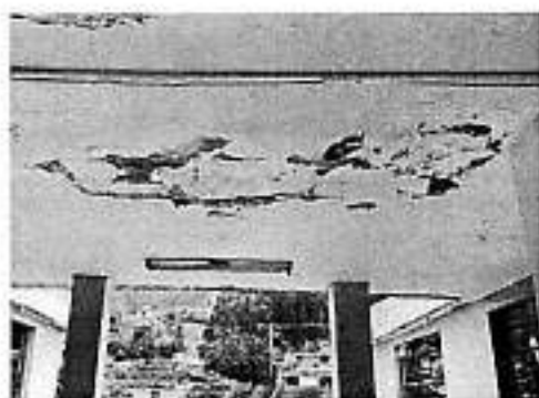
Fotografía N° 1 Humedades en tumbado
