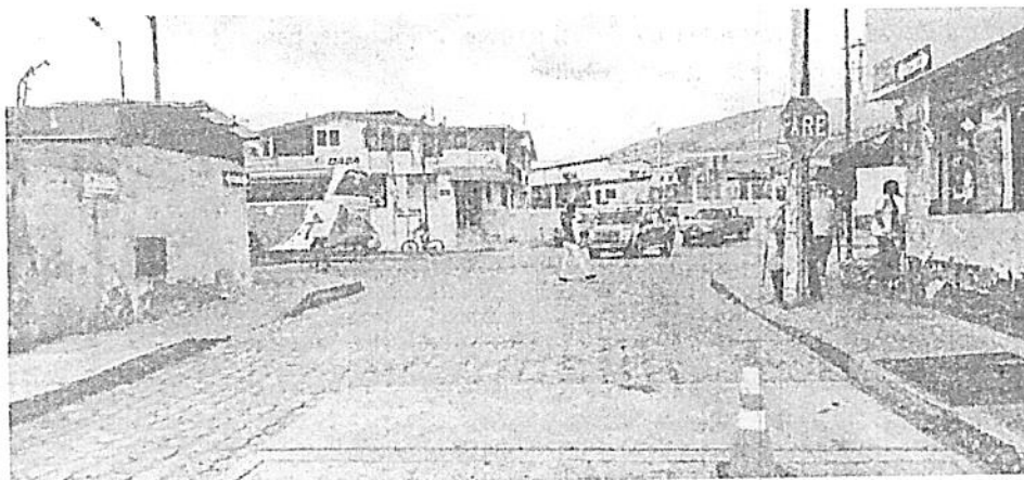
Imagen 2. Inexistencia de la construcción de sumidero transversal para la recolección de aguas lluvia.
