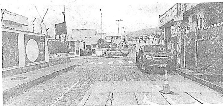
Imagen 6. Inexistencia de la construcción de sumidero transversal para la recolección de aguas lluvia.
