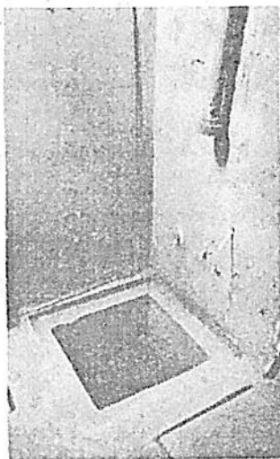
Imagen 1. Inexistencia de bomba sumergible en funcionamiento
