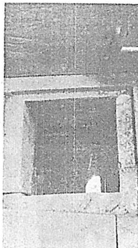
Imagen 7. Inexistencia de bomba sumergible en funcionamiento
