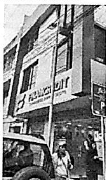
Luminaria mal ubicada y apagada L138
