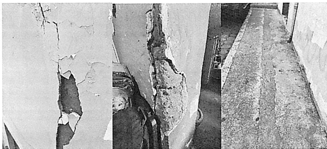
Imagen 12: Afectaciones en Muros. Fuente: Propia
